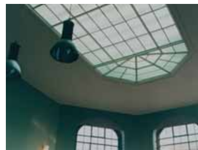
En esta aula del hospital universitario de Dresden, Alemania, se ha utilizado placa Lexan Thermoclear Drippard
