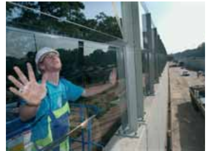
Pantalla de protección acústica a lo largo de la autopista entre los Países Bajos y Amberes de Koker Peerdsbos
